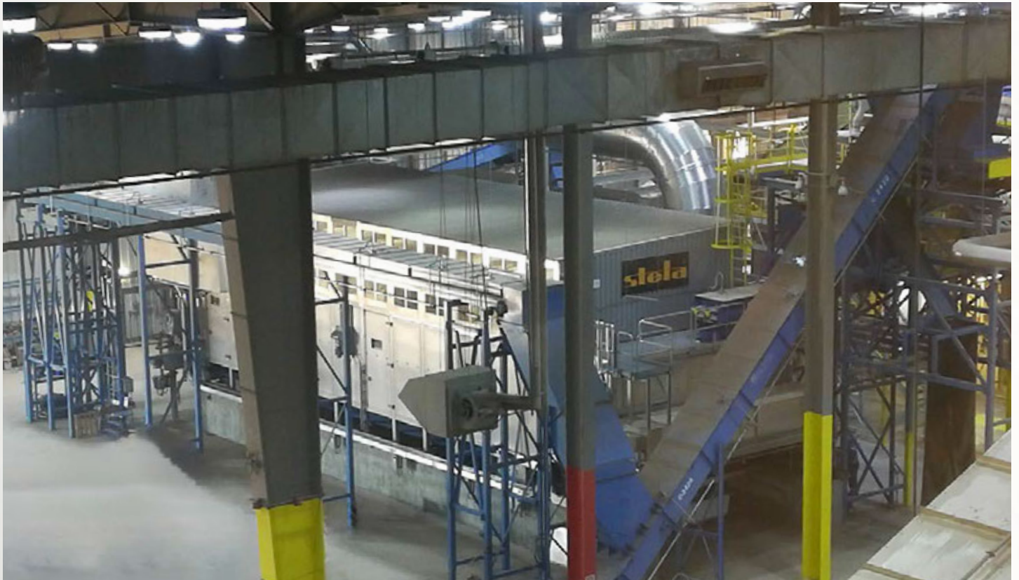
项目地：Edmonton Cement, 加拿大 | 型号：BTU 1/6200-18-3/2 | 安装年份：2018 干燥物料：RDF垃圾燃料 | 出料能力：约3.0吨/小时 | 降水区间：50% - 10%湿度
